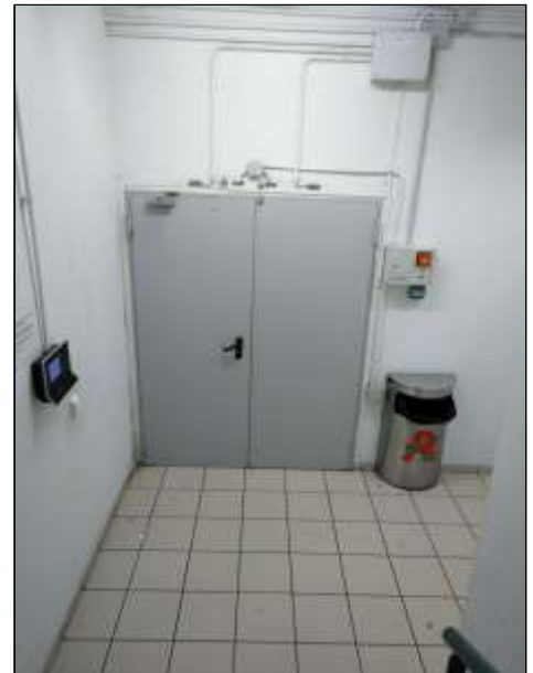
Puerta de acceso con alarma acústico-luminosa
