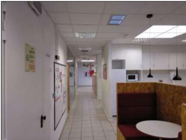
Pasillo de área de descanso sin aviso luminoso
